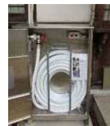
(易操作性1号消火栓)
