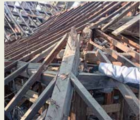
折れている屋根の一部（東立面図の青丸か所）
