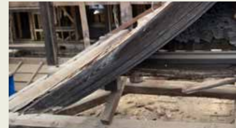
朽ちている玄関の屋根（東立面図の赤丸か所）
