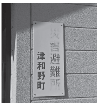
経年劣化した看板
