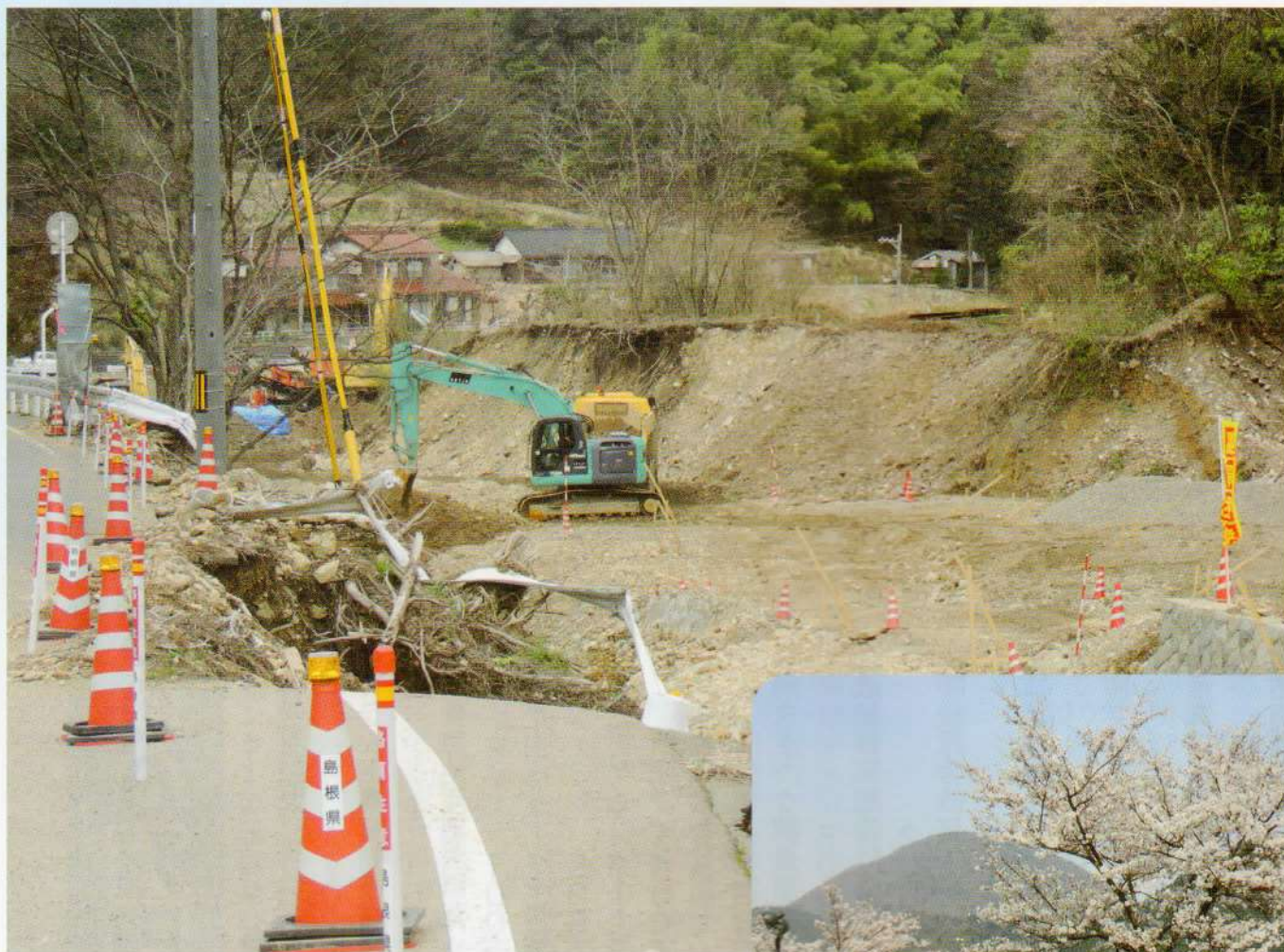
復旧が進む名賀地区
