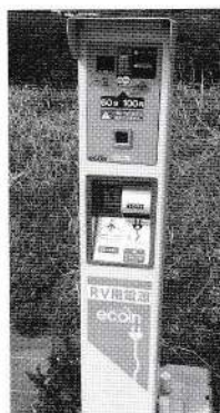
RVパークたまがわの電源施設
