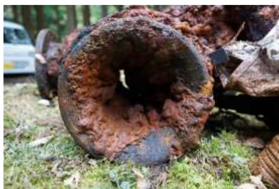
老朽化した管路内
