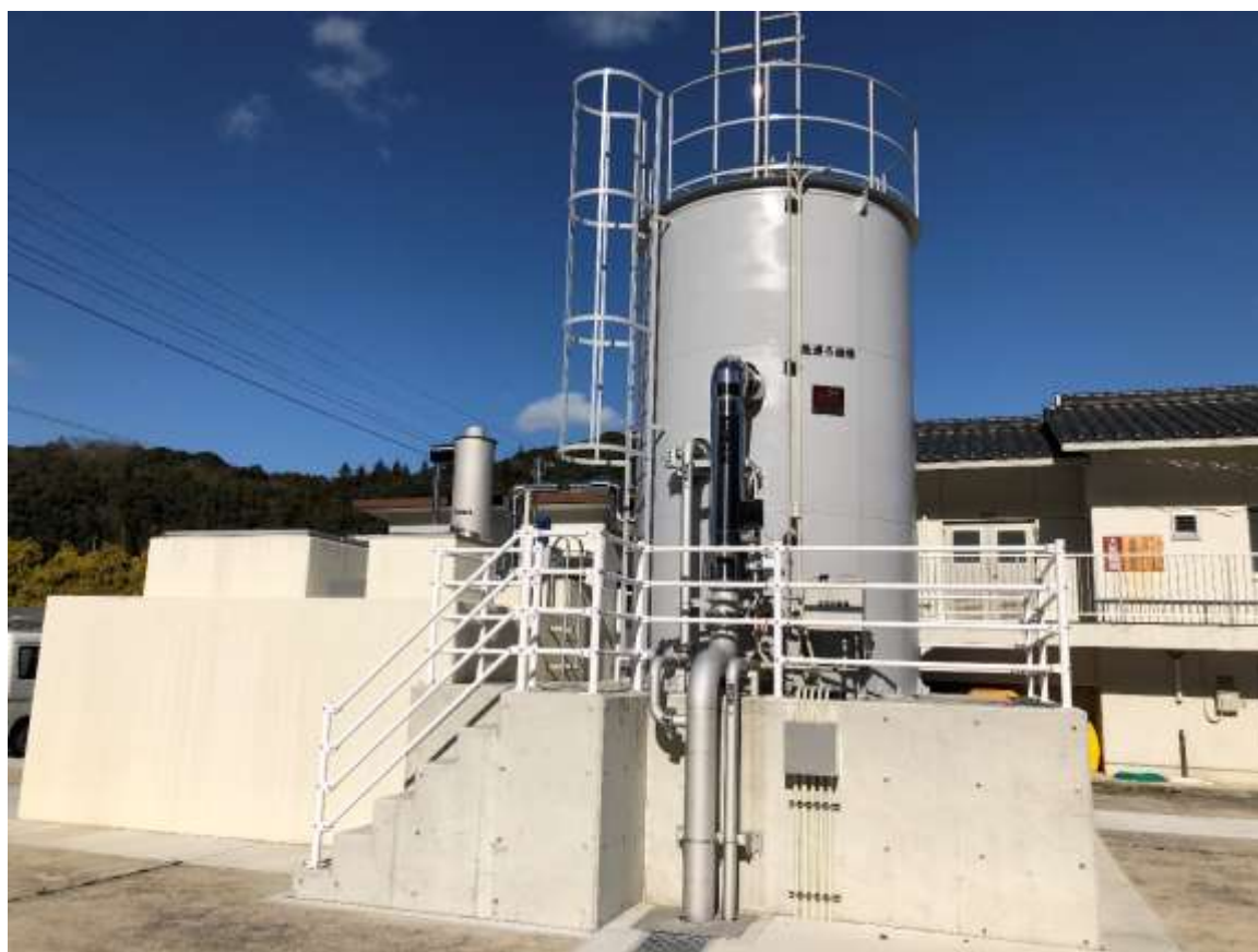
日原第 4 浄水場 急速ろ過装置
