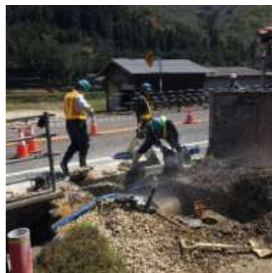
漏水中の現場
