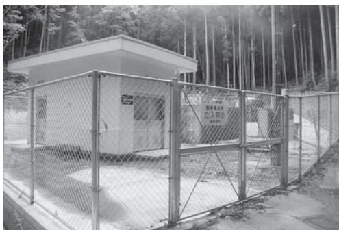
中曽野簡易水道 吹野地区配水池 (H19年度完成)
