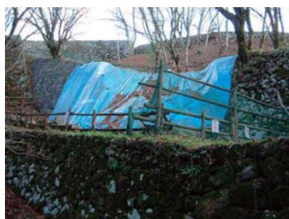
崩落した石垣
