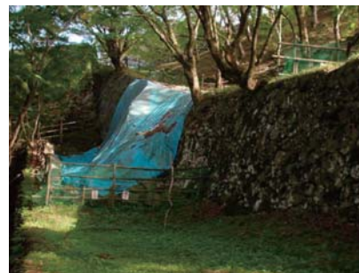
天守台北側の崩落した石垣
